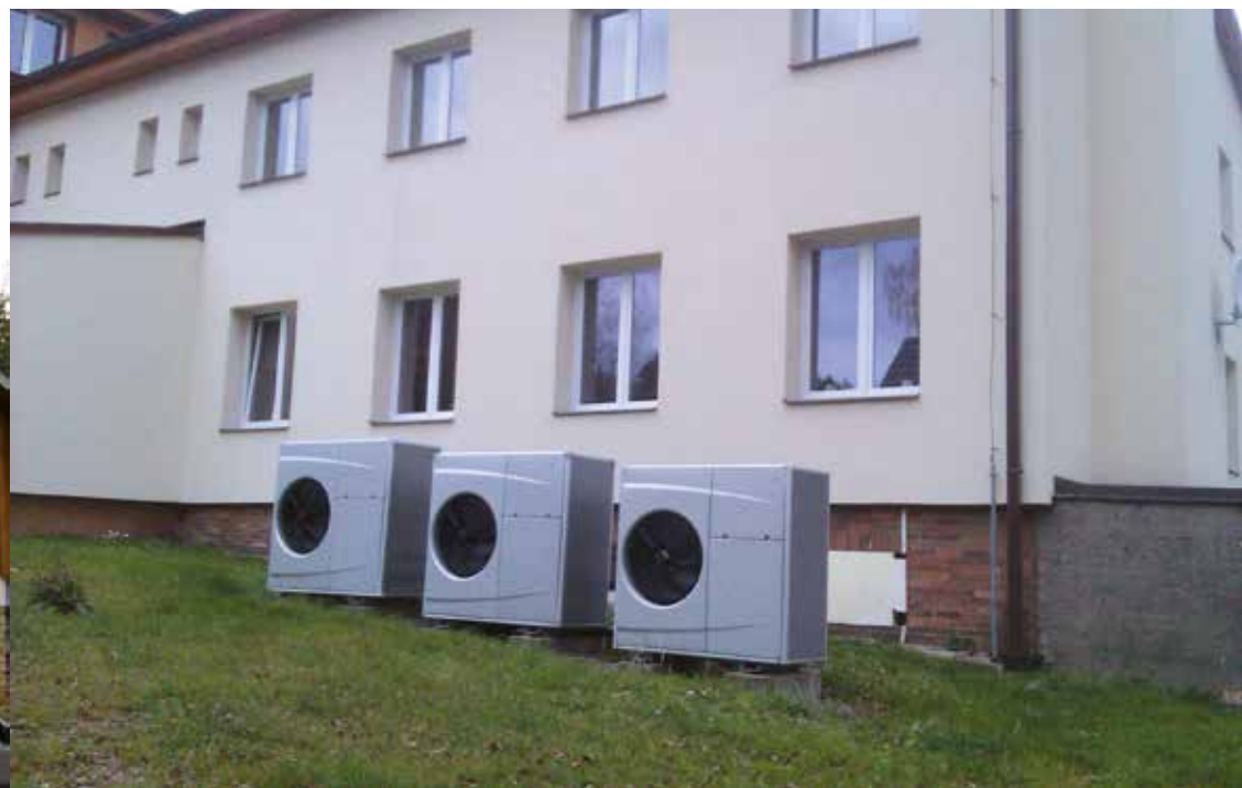
Tepelná čerpadla k vytápění penzionu (autor K. Srdečný)
