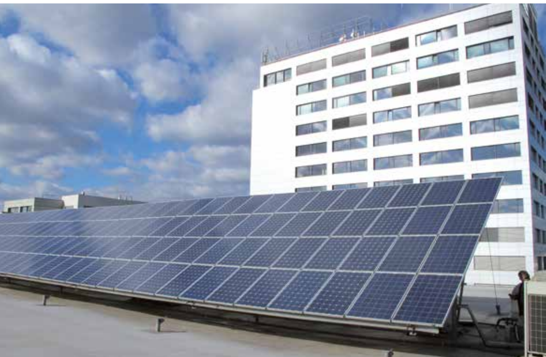
FVE Brno – Fotovoltaická elektrárna na střeše administrativní budovy, Brno (autor K. Srdečný)
