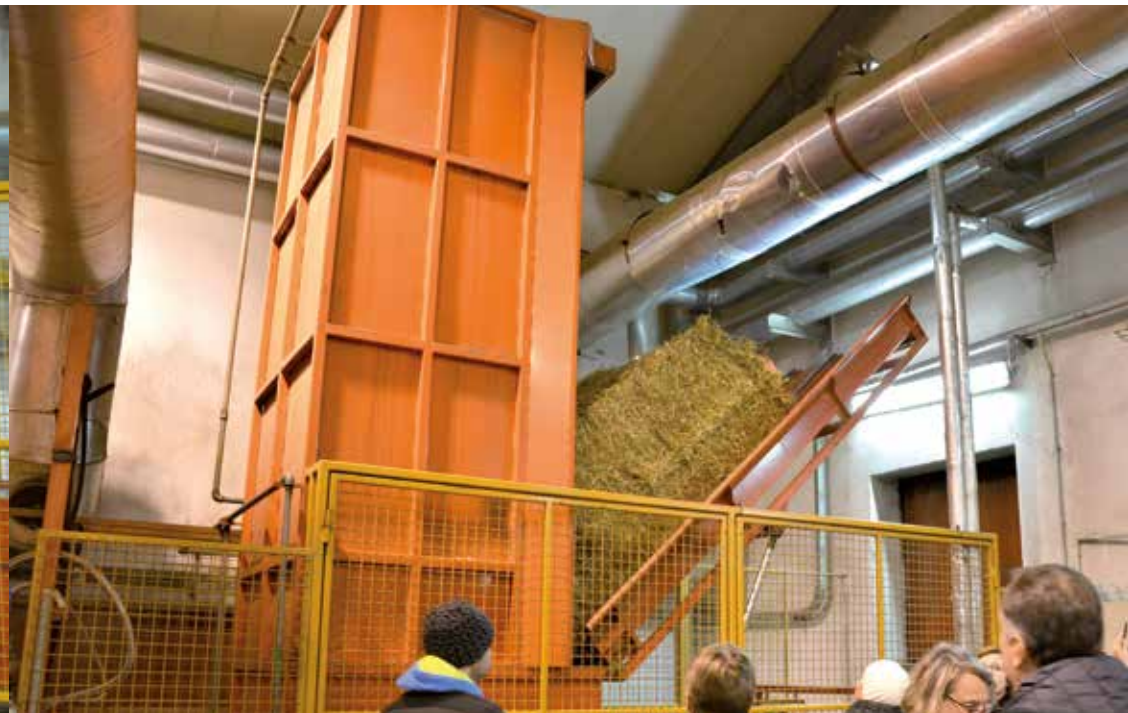
Z návštěvy obecní výtopny na slámu v obci Roštín, kde je připojeno 165 domácností
